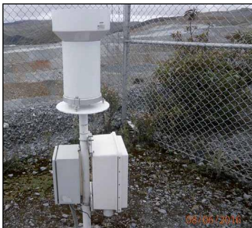
Fotografía 4.2: Estación pluviométrica EPCM1.
